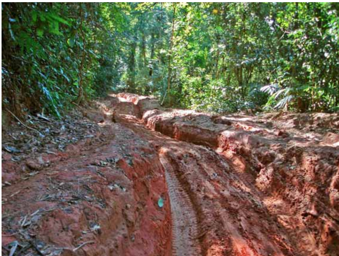
Foto 11, P. Noffs, 2007. Estrada de terra Perequê - Castelhanos em péssimo estado de conservação. Mesmo veículos com tração nas 4 rodas encontram muitas dificuldades para trafegar, principalmente na vertente da serra voltada para esta praia. Para a atual condição de tráfego, pode-se considerar que a Baía dos Castelhanos não tem acesso rodoviário.
